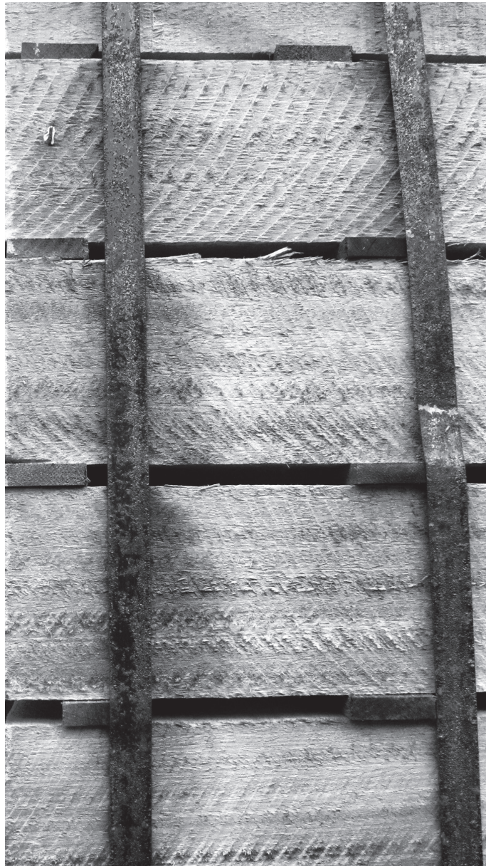
Afbeelding 33. Stalen bandijzer kan bij sommige houtsoorten tot een zwarte verkleuring leiden, wanneer het bandijzer in contact komt met het houtoppervlak en water. Deze verkleuring kan in een droogkamer versterkt worden. Foto: Innovita advies & projectbegeleiding
